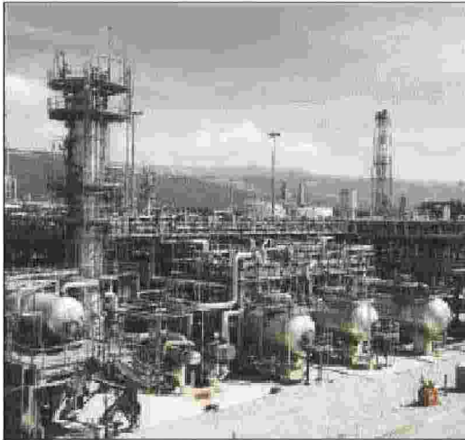
Il Centro olio dell'Eni di Viggiano
