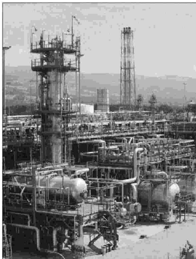
Il Centro olio dell'Eni di Viggiano
